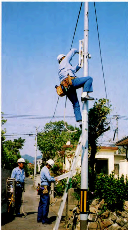
防犯灯の清掃点検を九州電気保安協会加治木出張所の職員がボランティアで実施した
